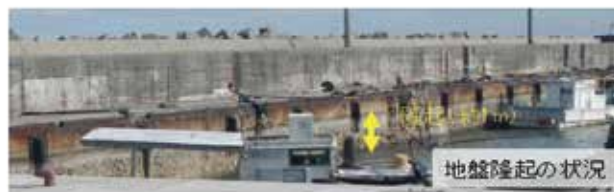
図-2 狼煙漁港(狼煙地区)の隆起状況
