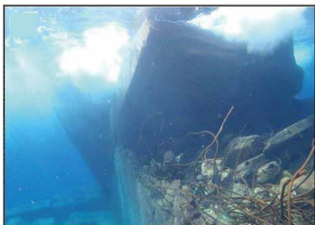
写真-2 大きく破損した第2沖防波堤(平成27年)
