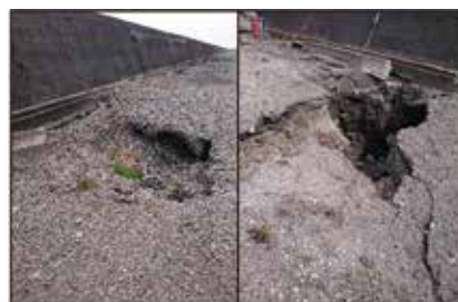
陥没発生状況
