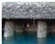
老朽化した岸壁
