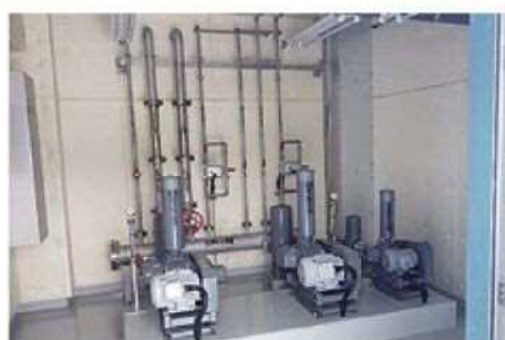
写真二 終末処理施設(ブロワ室)
