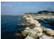
地震により岸壁が倒壊
