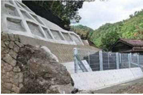
写真一6 土砂崩壊防止施設
