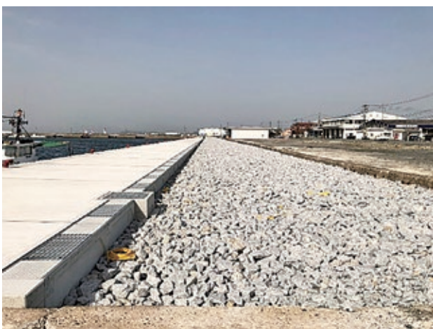
写一4 岸壁整備状況 上：ケーソン設置状況 下：岸壁前出し工事完了
