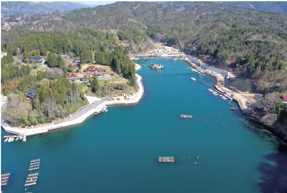
防潮堤等の工事が進む鶴ヶ浦漁港と漁港海岸（宮城県気仙沼市） （当センター東京本部 完山職員がUAVで撮影）
