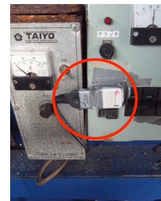
写真2 DC電源にプラグ接続状況
