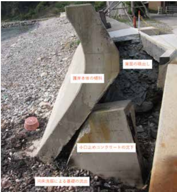
写真-3 護岸本体の傾斜、止めコンクリート沈下 査の結果に基づき随時「県庁協議」を重ね資料 取りまとめを行いました。
